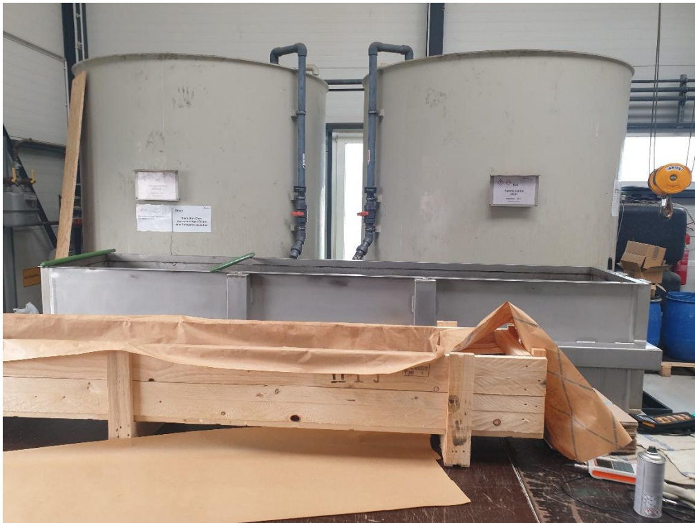
Abb. 9: Abwasser-Tank, Chromat mit Blei-Anoden, \approx 100 kg Schlamm / a, Abwasser wird per Tankwagen abgeholt
