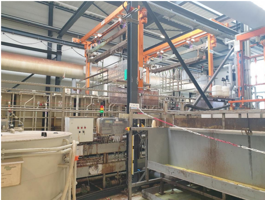
Abb. 5: Anlage in Betrieb, Fahrgestelle mit Teilen in den Tauchbädern
