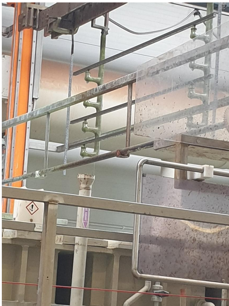
Abb. 6: Anlage in Betrieb, Fahrgestelle mit Teilen in den Tauchbädern
