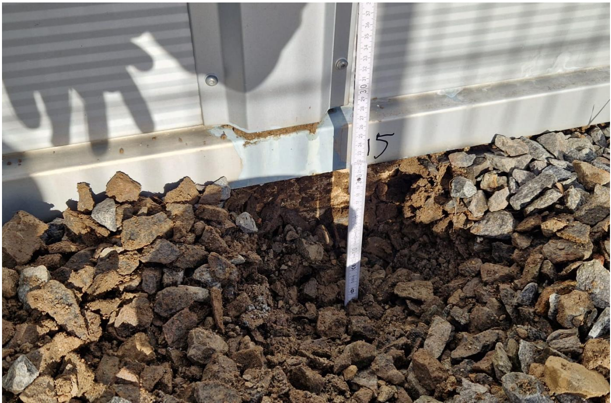
Abb. 13: Schotter an Außenwand Mittelsäule, Probe P 15
