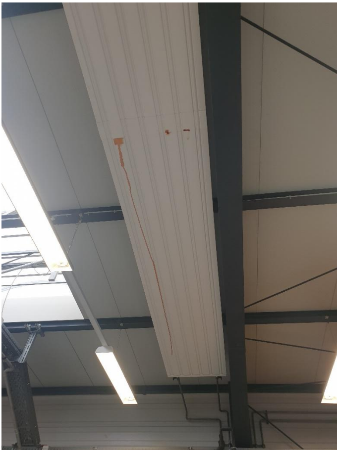
Abb. 24: Verspritzter Deckenheizkörper in Halle, vereinzelt braune Beläge an Deckenpanelen
